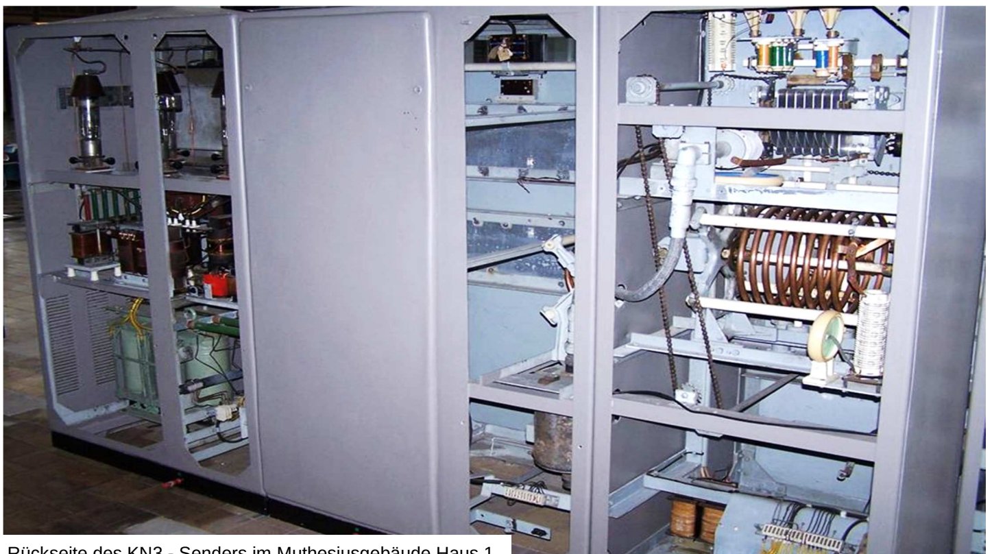
Rückseite des KN3 - Senders im Muthesiusgebäude Haus 1
