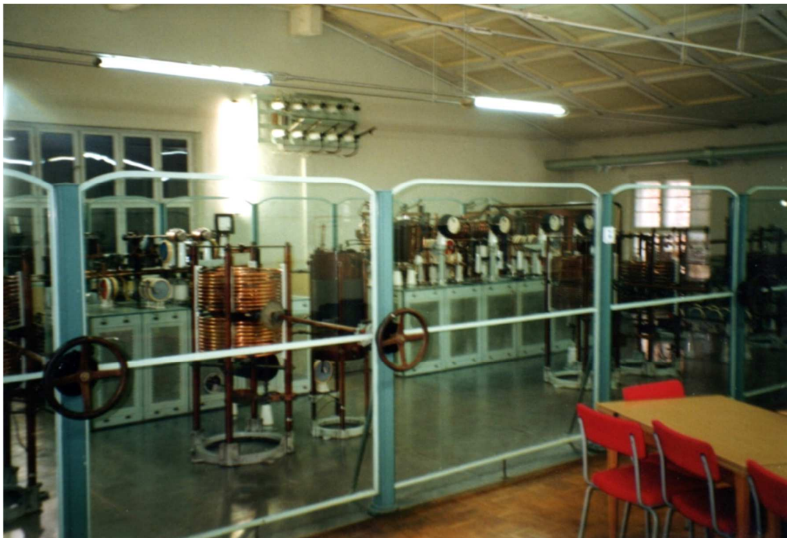
Der Sender 21 (Sender Tegel) mit den nach außen durch die Glasscheibenwand geführten Handlaufrädern zur Abstimmung der einzelnen Senderstufen. Im rechten oberen Bildbereich sind unterhalb der Decke zwei hellgrüne HF-Koaxialrohre des Sender 22 vom Typ Sneg PB 100 K zu erkennen, welche vom Sender 22 zu den Kurzwellenantennen hinter dem Sendehaus 2 führen. Bildquelle: Jan Balzer / Chemnitz
