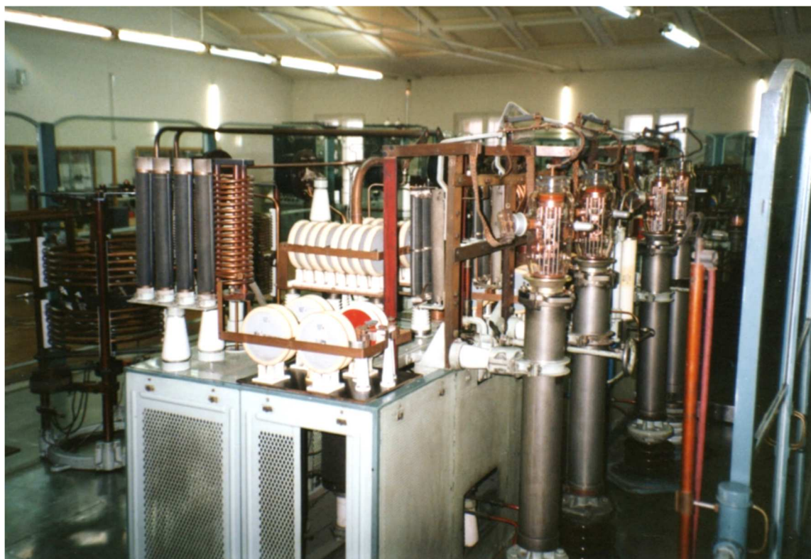
Blick hinter die HF-Leistungsstufe vom Sender 21 (Sender Tegel) mit den 4 wassergekühlten Leistungsröhren. Gut erkennbar sind die grau und rot gekennzeichneten Keramikscheibenkondensatoren. Die Farbkennzeichnung entspricht der Spannungsbelastbarkeit. Die Keramikscheibenkondensatoren sind als Paket in Reihen- und Parallelschaltung aufgebaut. Links neben den Keramikscheibenkondensatoren die Lastwiderstände aus gewickeltem Konstantandraht. Die Verwendung von Konstantan als Drahtmaterial ist erforderlich um bei hohen Temperaturschwankungen den einen gleichbleibenden Widerstandswert zu gewährleisten.
